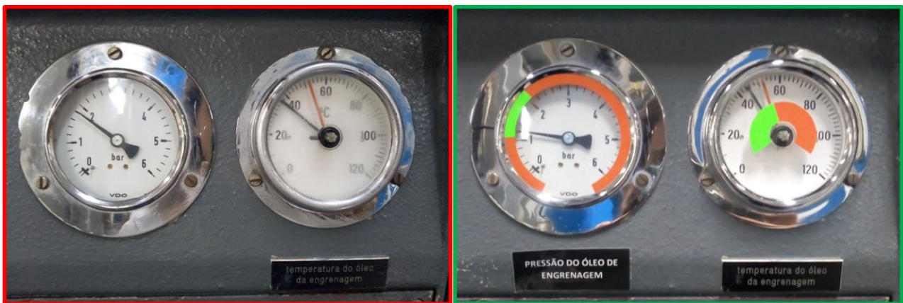
Indicadores de pressão e de temperatura do óleo de engrenagem da extrusora sem gestão visual
