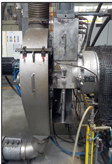
Figura 5.5 - Pormenor da unidade de extrusão de uma das linhas da Cabopol 1. Da direita para a esquerda: cabeça da extrusora, câmbio de filtros e câmara de granulação.
